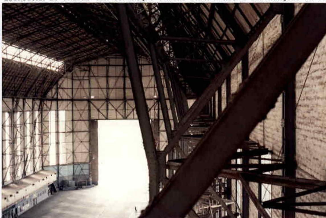
18 - ESTRUTURA DO PRÉDIO VISTA DE UMA DAS ESCADAS DE ACESSO AO TETO. OBSERVAR MARCAS DE OXIDAÇÃO NAS TRAVES DE FERRO
